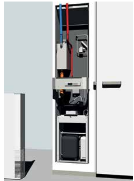
Vattenledningar kopplas från en externt placerad kondensator till kylaggregatet.
